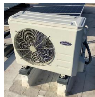
Mini Split HP Condensing Unit
